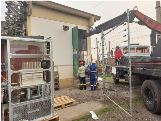
Figura 18 – Subestação de energia
